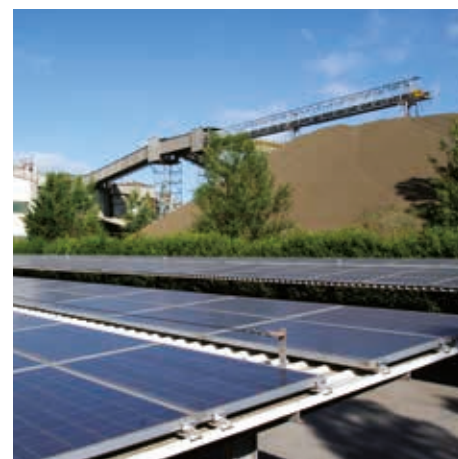
Impianto fotovoltaico nello stabilimento di Rubbiano (PR).
