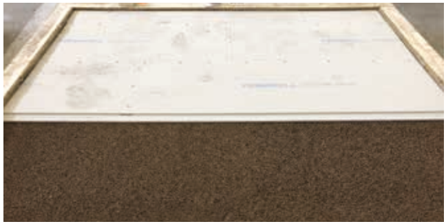
Posa delle lastre in gesso fibra di spessore 2 cm sullo strato di sottofondo a secco in PaviLeca.
