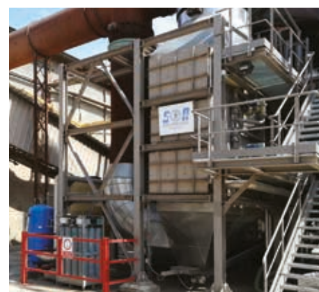
Impianto di recupero di calore nello stabilimento di Rubbiano (PR).
