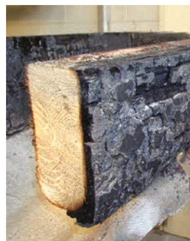
Trave in legno dopo un incendio.
